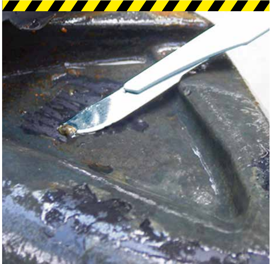
EPDM-schuif van een ander merk na zes maanden - een mooi voorbeeld van microbiologische groei op een onjuist geformuleerde rubbersamenstelling.
